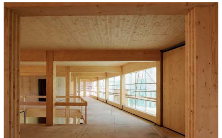
Das Wohnhaus in Massivholzweise speichert bis zu 520 t CO 2 . Das Bild zeigt eine Wohneinheit im Rohbau. Foto: Peter Eichler | www.asuna-leipzig.de
